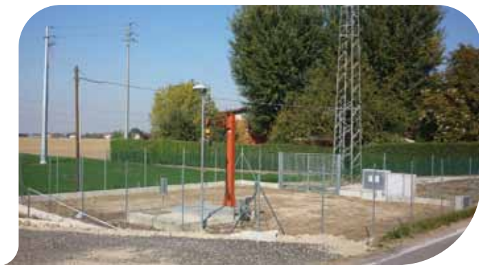
Impianto sollevamento acque fognarie della Riccardina
